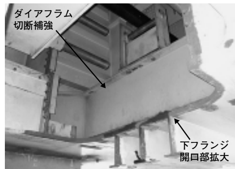
写真-6 下フランジ開口部拡大状況
