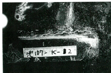
写真-1 隅角部のき裂損傷
