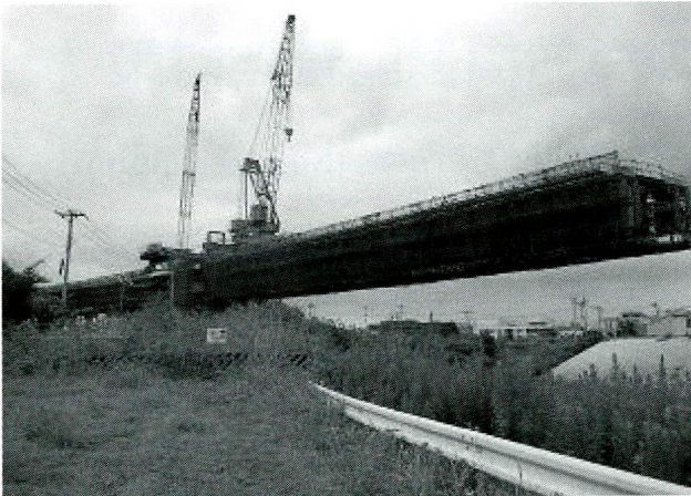
写真-2 台風接近時のトラベラクレーンの後退状況 (5パネル張出し状態)
