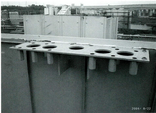
写真-3 支柱固定治具
