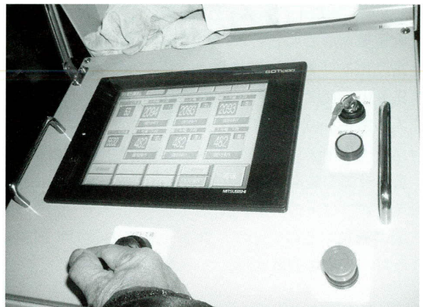
写真-13 デッキリフト操作パネル
