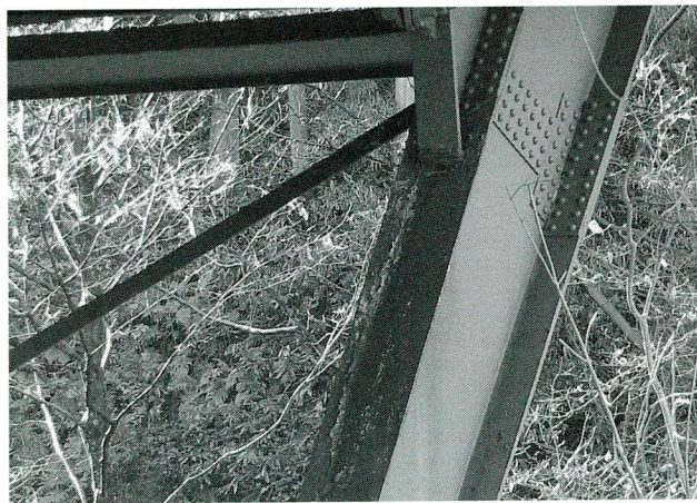
写真-15 ラーメン脚の塗装劣化部
