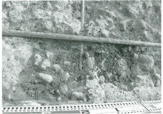
写真-9 床版コンクリート劣化部
