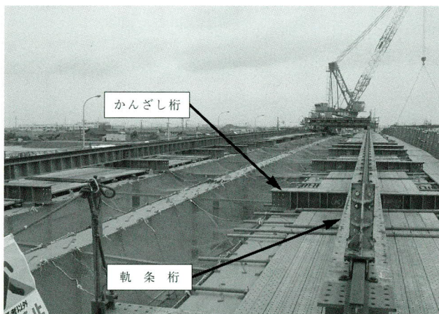
写真-5 クレーン・台車軌条
