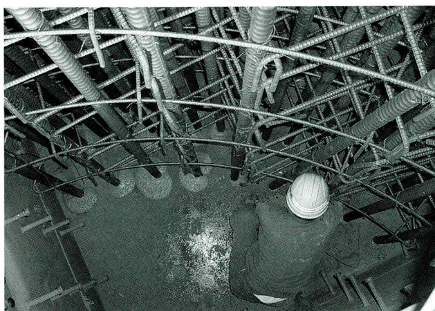
写真-3 下フランジフロー状況
