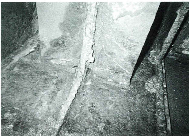
写真-8 支承受台内部腐食
