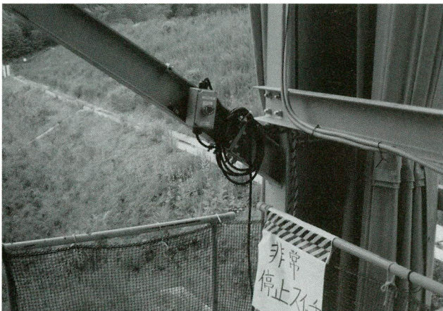
写真-18 非常停止ボタン
