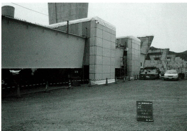
写真-4 風防設備 (サポータータイプ)
