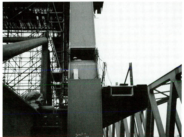
写真-9 ハブルグ市鉄道橋(ワーレントラス弦材)の全断面現場継手
