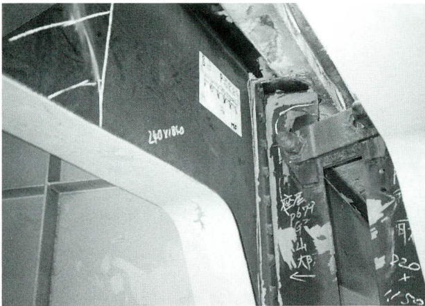
写真-30 若宮出路S3桁端部の損傷
