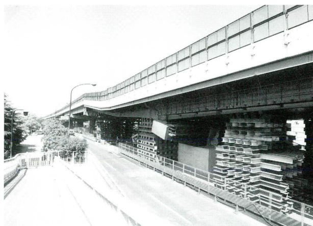
写真-7 3径間連続RC床版鋼箱桁が全体座屈により破壊
