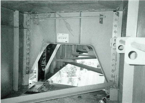
写真-29 若宮出路S3端横桁の損傷
