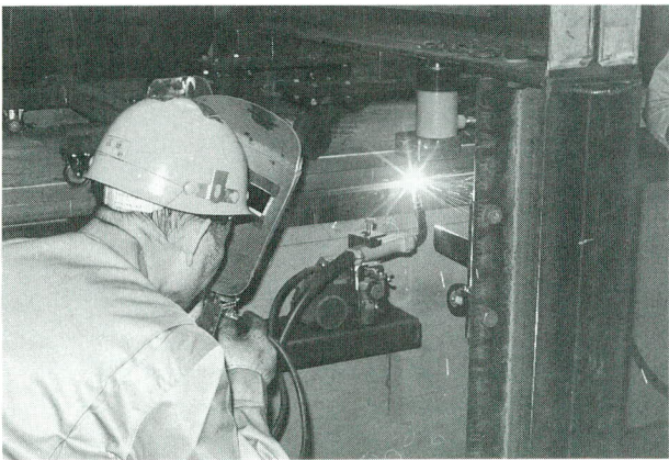
写真-4 コ組立時の自動仮付け・シーリング溶接状況の一例
