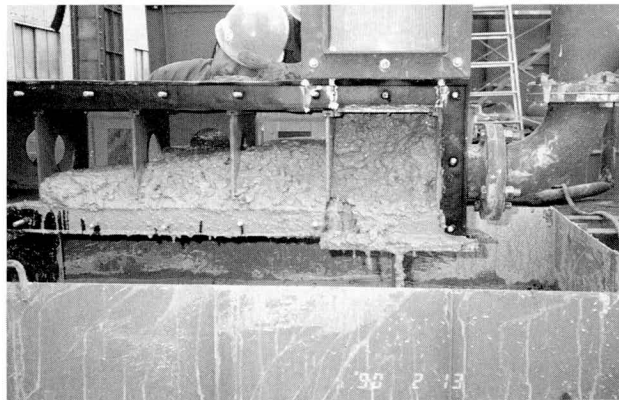
写真-5 モルタルが分離して充填不能になった状況
