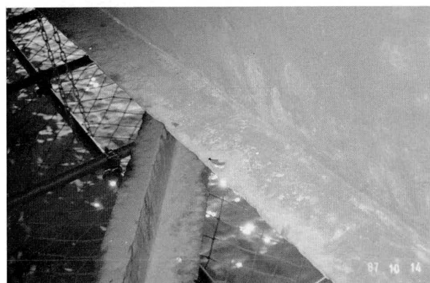
写真-3 鋼材腐食状況 (縦桁下フランジ)
