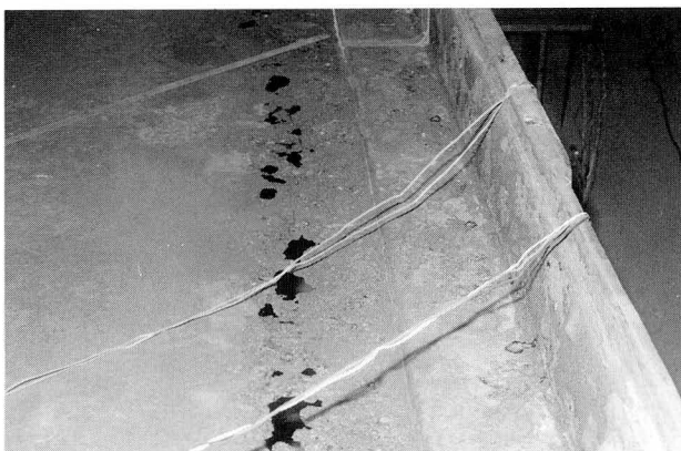
写真-5 ウェブの腐食状況
