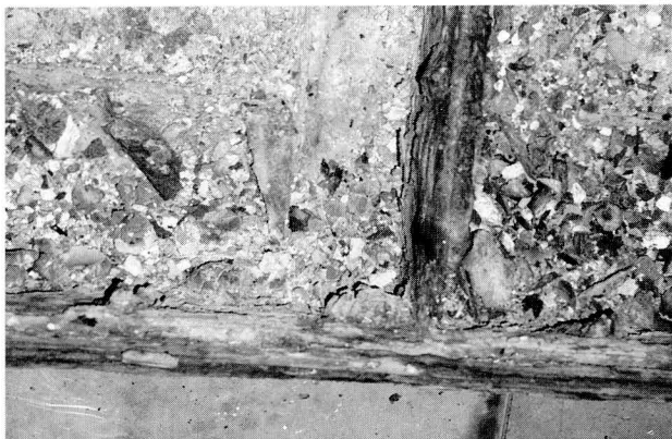
写真-7 補剛材下部とリベットヘッドの腐食状況
