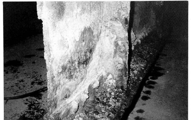
写真-2 撤去直後の桁の損傷状況
