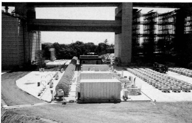
写真-9 4Aリーリングヤード
