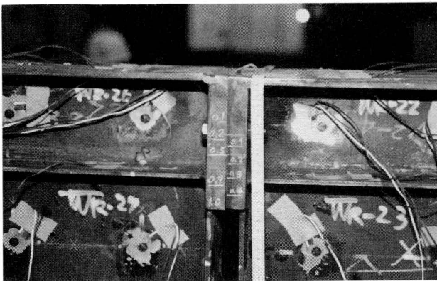
写真-5 支圧・ピン継手支圧部の肌すき (右)
