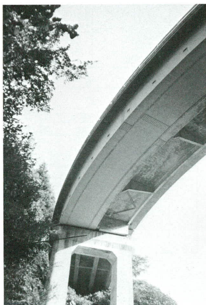
写真-2 張出部の床版クラック状況
