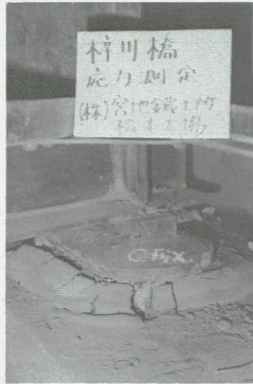
写真-10. AI橋台固定沓 (C桁)の破損状況
