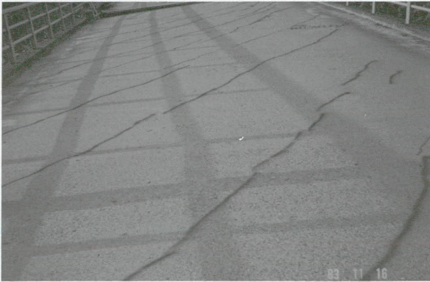
写真-3. 床版の亀裂状況
