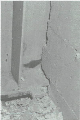
写真-4. AI橋台パラペット 破損状況
